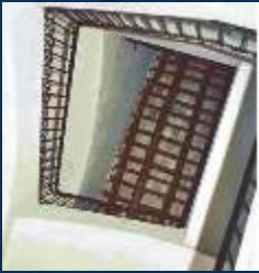
Caixa de l'escala d'accés a la sala, a les golfes i al colomar. Foto: Toni Castellà, 2006
